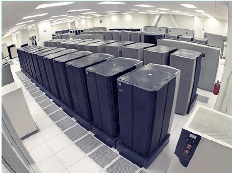
1 MW Data Center
